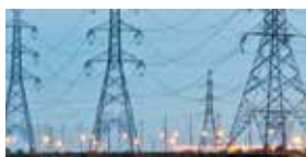
Produzione Energia Energy
